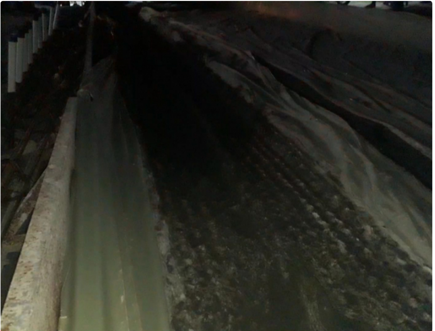
Kondisi Lean Concrete atau LC yang rusak dilindas mobil mixer
